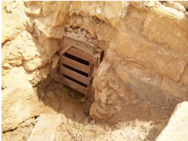
صورة (٢) توضح ارتفاع منسوب المياه الأرضية أسفل أساسات المعبد ومدخل السرداب في الواجهة الجنوبية
